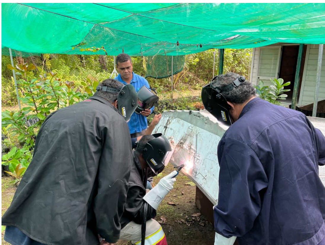
Formation à la soudure de l'aluminium et la réparation des coques à Futuna
