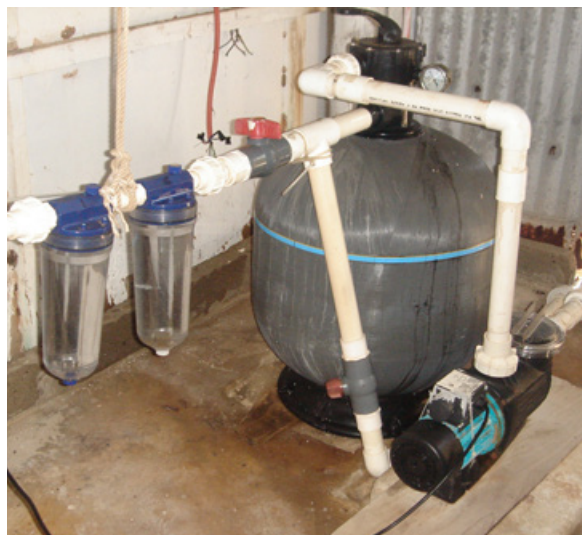
Système de filtrage de l'eau dans une zone de quarantaine
