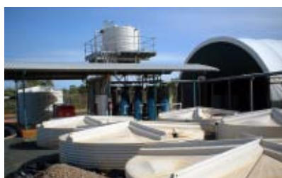
Une vue des citernes d'eau et des installations techniques des tunnels de l'écloserie
