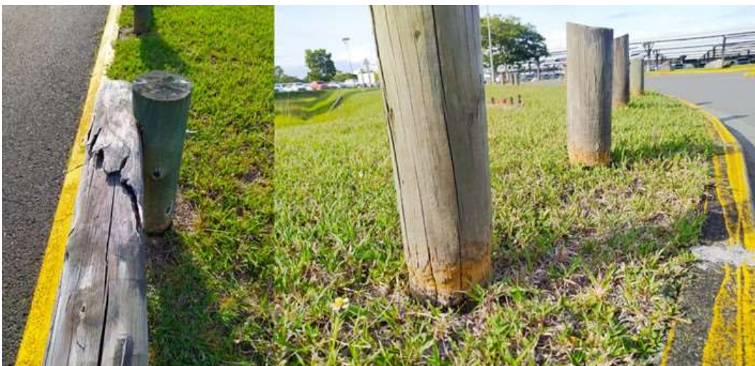
Photo 23. Barrières et poteaux de protection, pin des caraïbes traités CCA, La Tontouta
