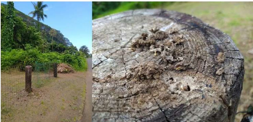
Photo 28. Poteau de clôture, dégradé par des termites, Tahiti
