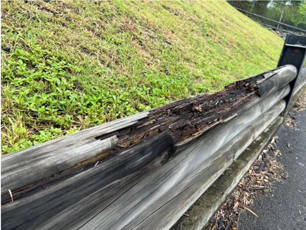
Photo 9. Mur de soutènement dégradé par une pourriture cubique, pin*, Nouméa
