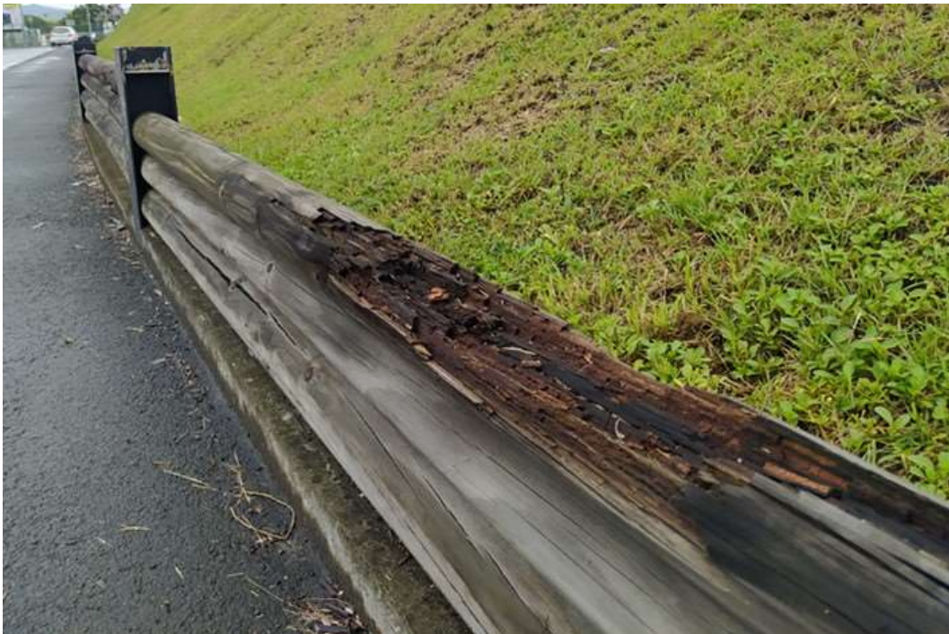
Photo 7. Mur de soutènement dégradé par une pourriture cubique, pin*,
