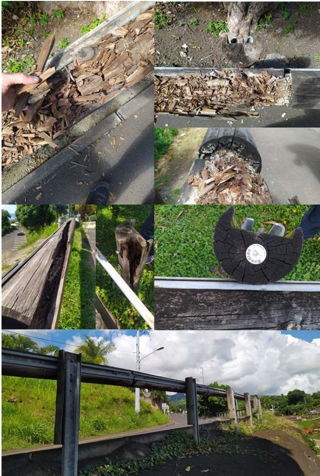
Photo 36. Sinistres observés sur des glissières de sécurité en mixte bois-métal, pin sylvestre traité « classe 4 » au KORASIT KS2, Tahiti
