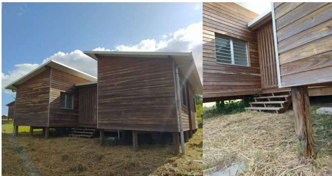
Photo 20. Maison bois sur pieux en bois (pin des caraïbes traité Wolmanit), avec présence de pourriture fibreuse 5 ans après la mise en œuvre, Bouloupari
