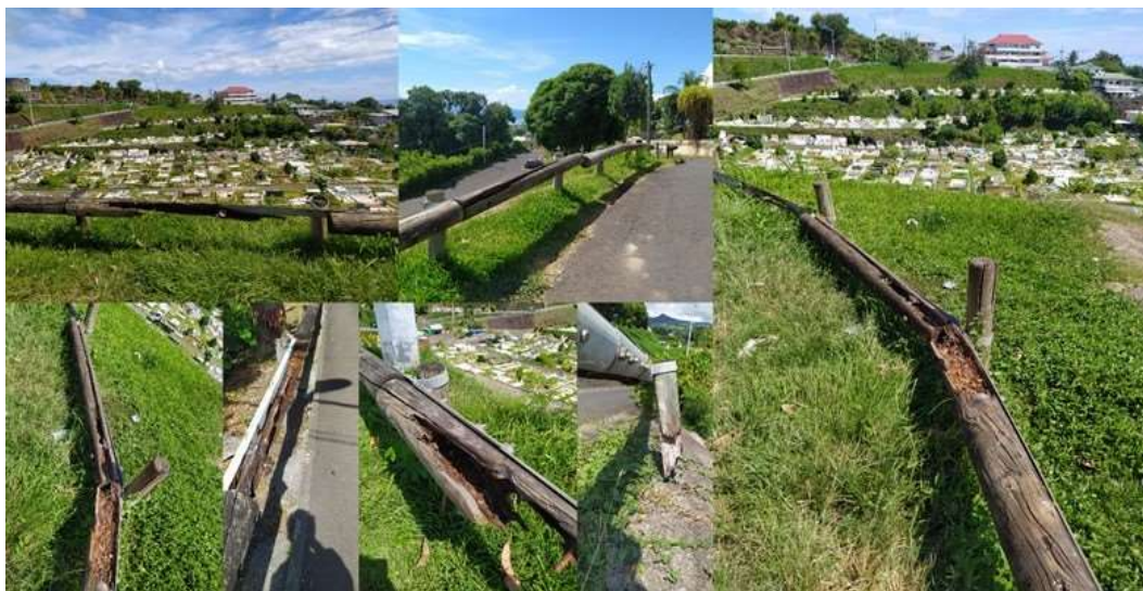
Photo 37. Sinistres observés sur des glissières de sécurité en mixte bois-métal, douglas traité « classe 4 » au Wolmanit-CX, Tahiti
