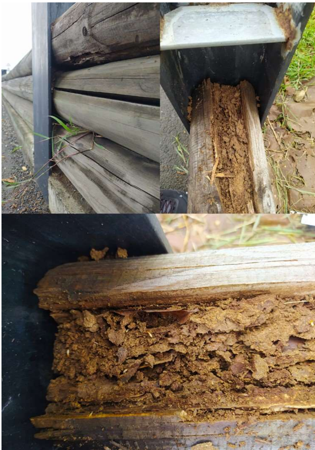
Photo 8. Mur de soutènement dégradé par des termites, pin*, Nouméa
