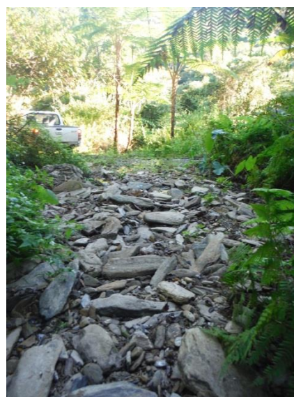
Figure 11 : Zone de dépôt d'un affluent non permanent de la Tipoi traversant la piste d'accès au captage Restauration forestière
