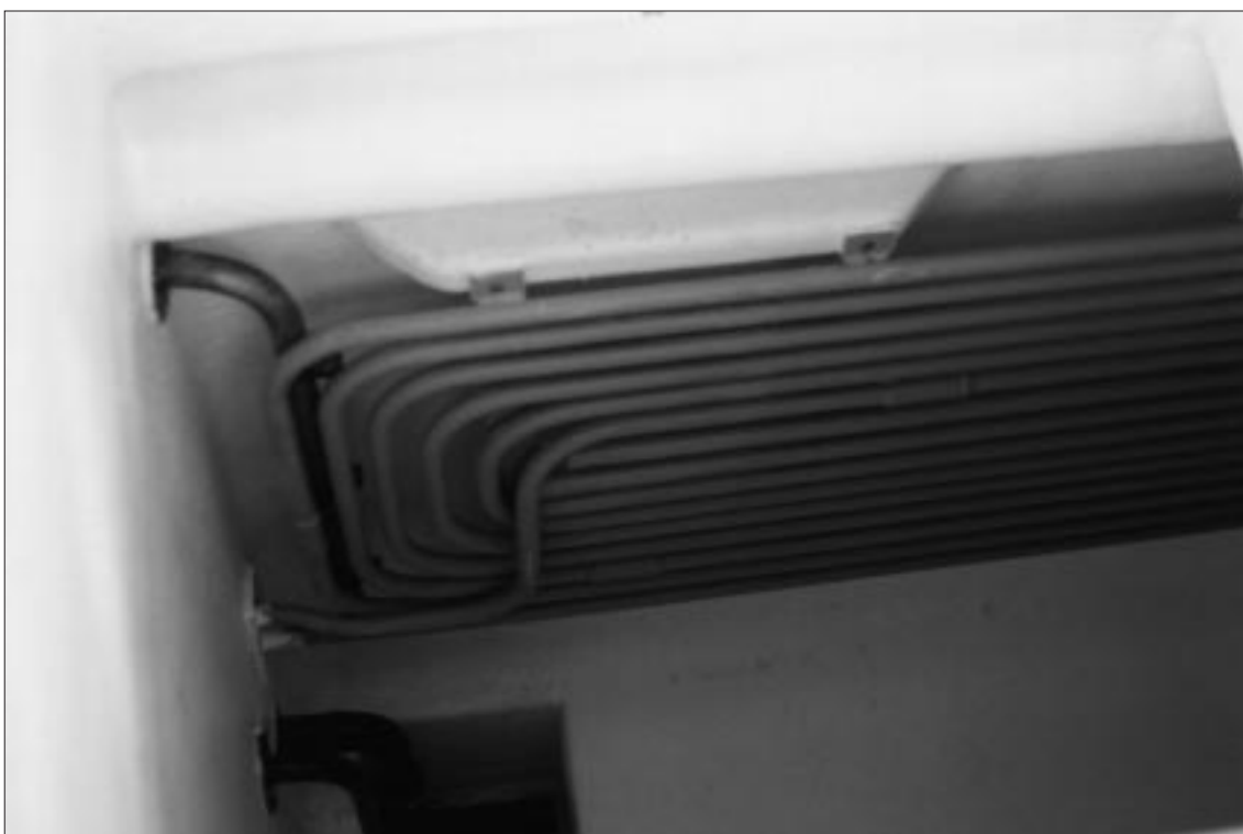
Figure 11 : Les tuyaux de réfrigération et le puisard de l'un des six réservoirs d'eau de mer réfrigérée
