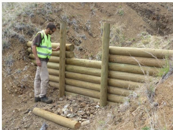
Seuil en bois simple paroi - Déva (Bourail)
